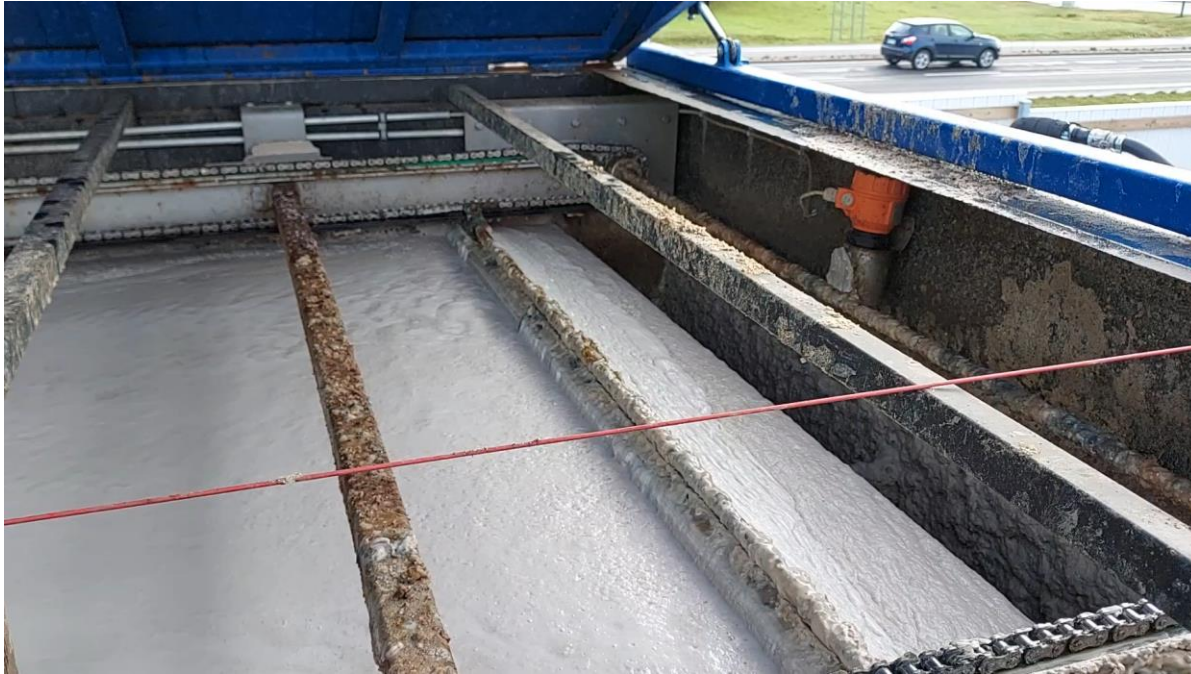
DAF-prosessi (OWATEC Group) Hätälän jätevesien esikäsittelyssä
